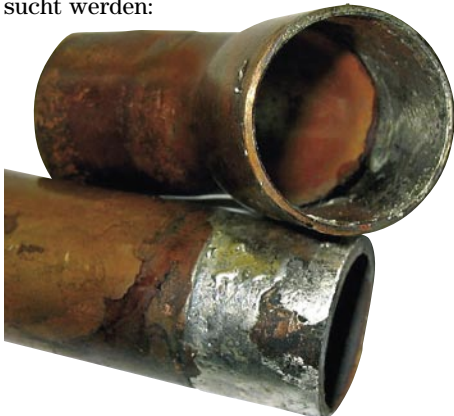
Bild 1 Cu/Cu mit Weichlot; das Schadensbild deutet auf Überhitzung hin
