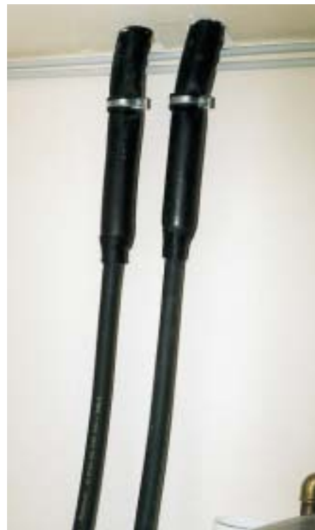
Mehr ist zwischen Ober- und Untergeschoß nicht zu sehen. Armaflex-isolierte Vor- und Rücklaufleitung für die Fußbodenheizung-Direktkondensation mit dem Kältemittel R 407C
