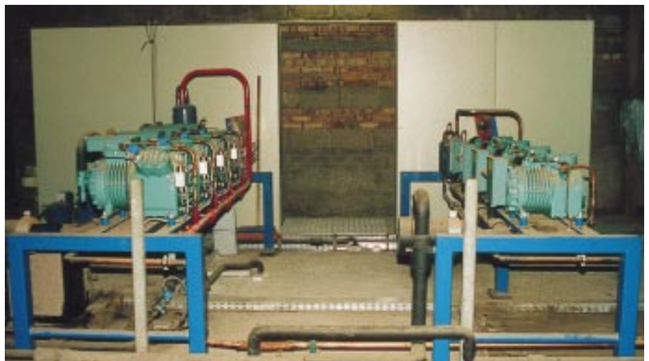
Im Vordergrund die beiden Verbundkälteanlagen für die Plus- und Minuskühlung, dahinter zu sehen die Schaltschränke für die MSR-Technik sowie die Datenfernübertragung
