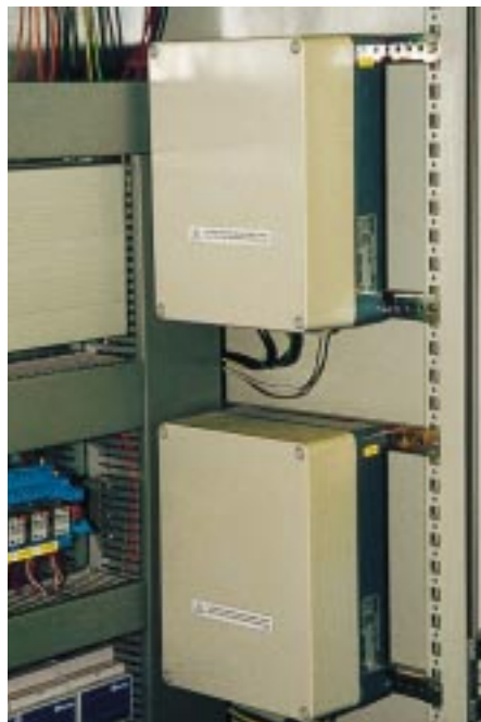
In einem der beiden Schaltschränke befinden sich auch die Frequenzumformer für die Verflüssigerventilatoren
