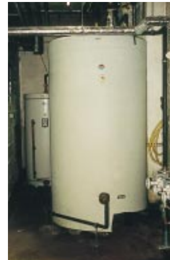
Insgesamt 3 Wärmerückgewinner sorgen dafür, daß ein Teil der Wärmeenergie wieder sinnvoll verwendet werden kann
