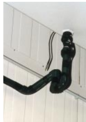
Einer der beiden Sensoren zur Überwachung der Lagertemperatur befindet sich direkt unter dem Verdampfer
