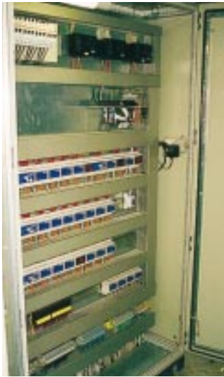
Innerhalb des Schaltschranks mit den Kühlstellenreglern...
